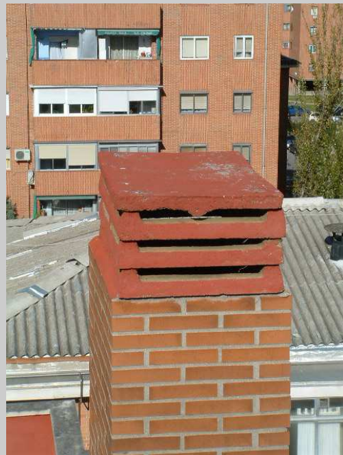
Defecto en remate de chimenea
