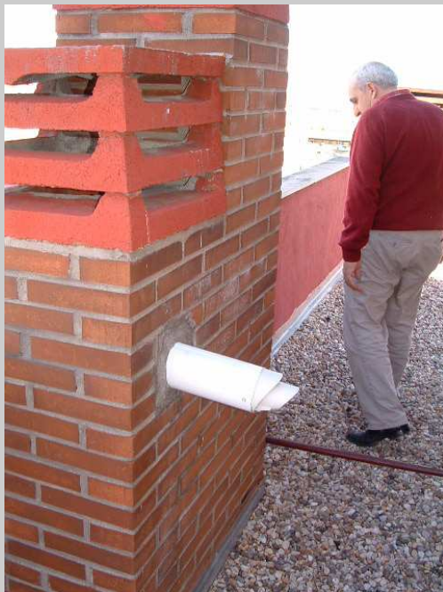
Invasión de conducto de ventilación por otro
