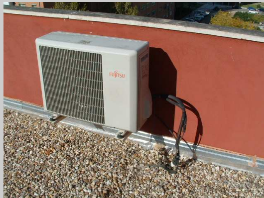
Tubos de instalaciones atravesando la impermeabilización
