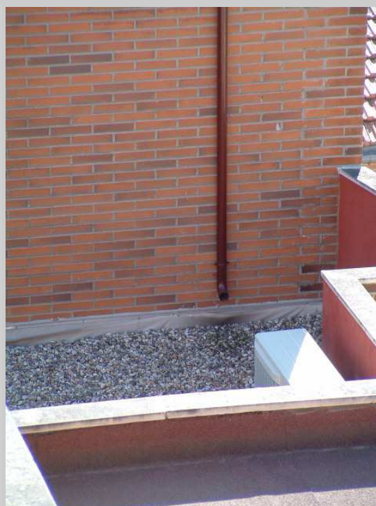
problema de los mechinales y de las canalizaciones de los mismos en los torreones de las cajas de escaleras
